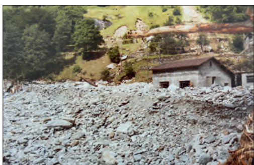
La centrale elettrica del Zardign devastata dalla furia delle acque.
