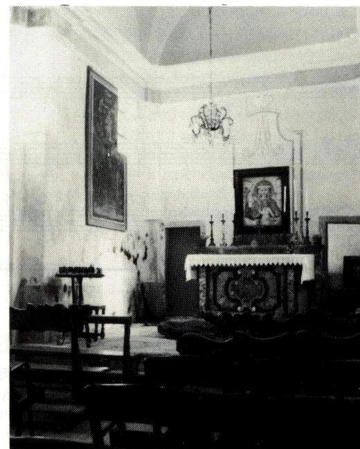
Oratorio del Sassello, interno. Notasi i segni dell'umidità sulla parete a sinistra.
