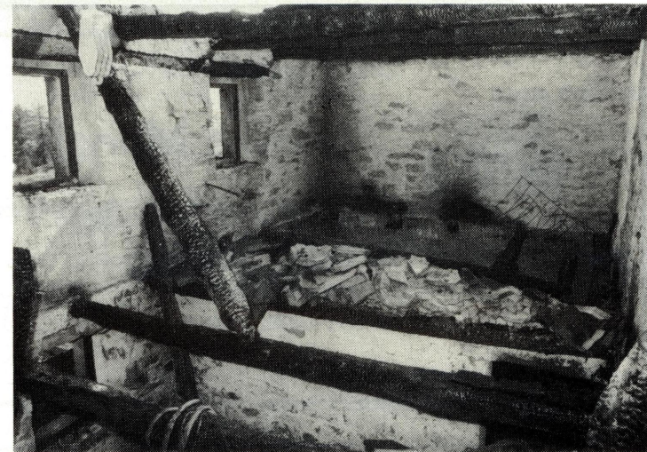
Eloquente immagine del danno causato dalle fiamme.
